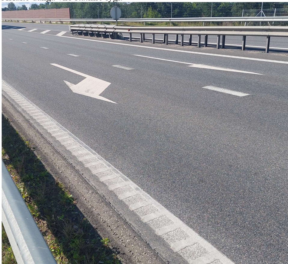
Asfalto danga virš statinio lygi.
