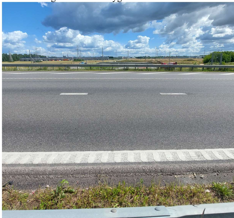
Asfalto danga virš statinio lygi.
