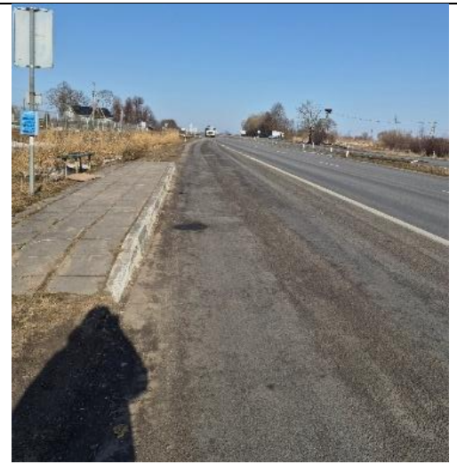
62 pav. Valstybinės reikšmės krašto kelio Nr. 141 Kaunas – Jurbarkas – Šilutė – Klaipėda (kairė pusė) 221,68 km esanti autobusų sustojimo aikštelė „Dumpiai“ įvažoje be keleivių laukimo stoginės (žiūrint į Klaipėdos pusę)
