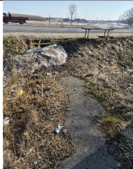
64 pav. Tako priėjimas su laipteliais prie autobusų sustojimo aikštelės „Dumpiai“. Tako dangą – blogos būklės asfaltas
