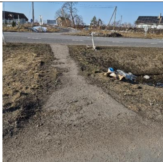
56 pav. Valstybinės reikšmės krašto kelio Nr. 141 Kaunas – Jurbarkas – Šilutė – Klaipėda 221,78 km esantis neženklitas pėsčiųjų praėjimas per skiriamąją juostą (danga blogos būklės asfaltas)
