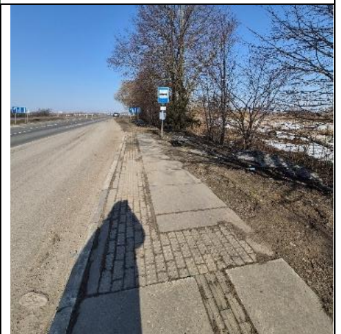
59 pav. Valstybinės reikšmės krašto kelio Nr. 141 Kaunas – Jurbarkas – Šilutė – Klaipėda (dešinė pusė) 221,84 km esanti autobusų sustojimo aikštelė „Dumpiai“ įvažoje be keleivių laukimo stoginės (žiūrint Klaipėdos kryptimi)
